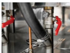
Sistema de escoamento conectado diretamente ao esgoto.
