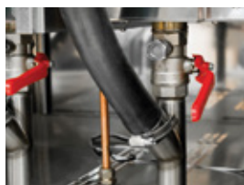
Sistema de drenaje conectado directamente al alcantarillado.
